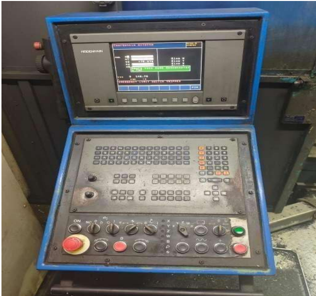
Figura 2: Vista do Pannel de Comando defasado da Mandriladora TOS.
