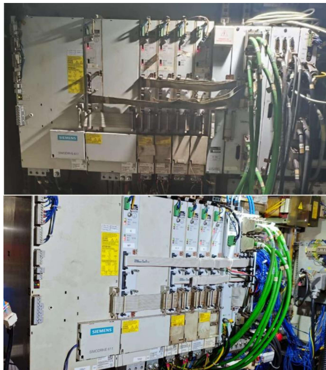
Figura 9: Antes e depois da substituição das placas de comunicação, fonte de alimentação dos drives e interfase de comunicação Simodrive da SIEMENS.
