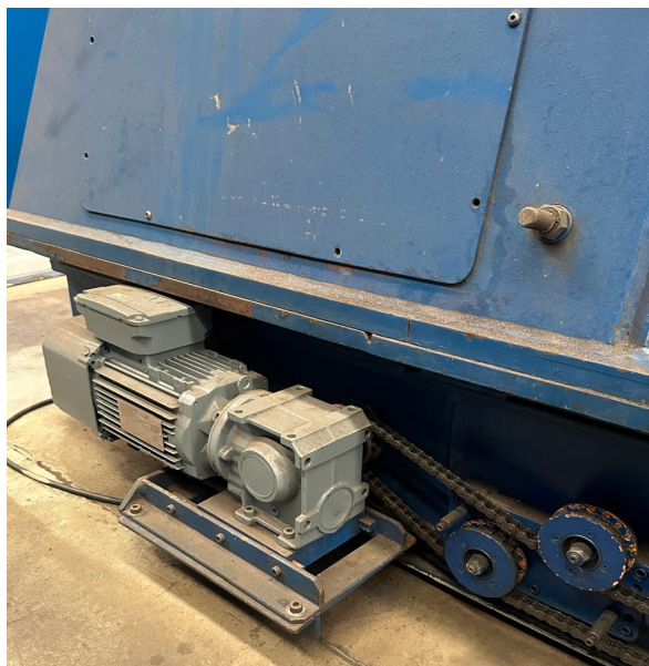
Figura 12 - Motor, redutor e engrenagens instalados na mesa fixa.
