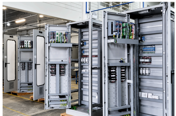
Fig. 4. Foto de um painel de medição e proteção [8].
