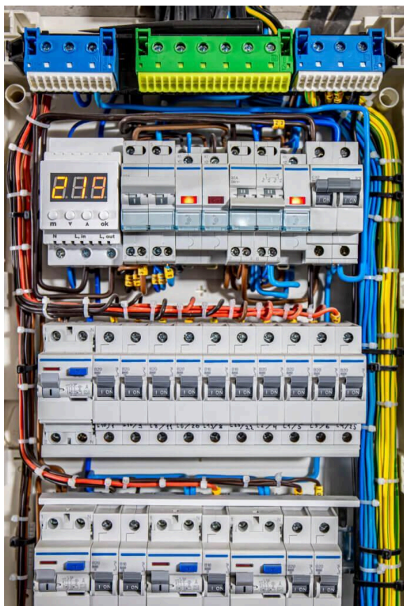
Fig. 1. Foto de um painel de distribuição [2].
