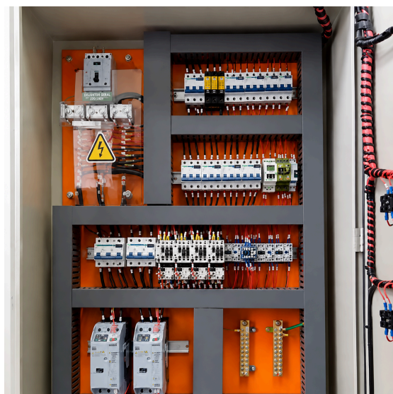
Fig. 3. Painel centro de controle de motores [6].
