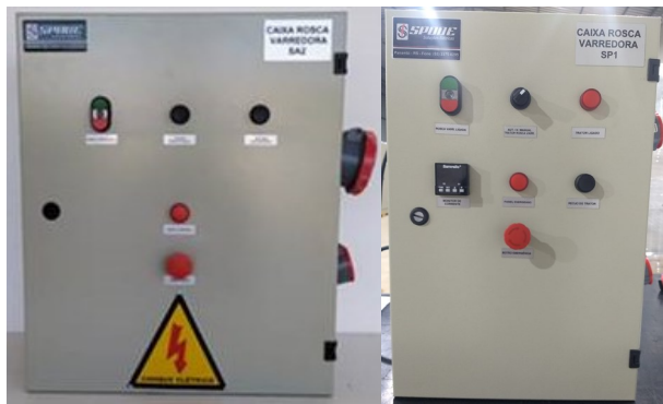
Fig. 12. Quadro de proteção e comando rosca varredora convencional (esquerda) e automatizado com relé monitor de corrente (direita).
