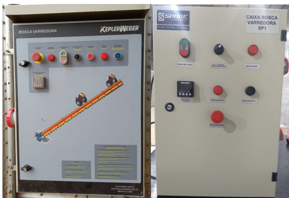
Fig. 11. Quadros de comando e proteção para rosca varredora automatizada encontrados no mercado.
