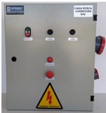
Fig. 10. Quadro de comando e proteção convencional rosca varredora com trator sem automação.
