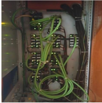
Figura. 13 – Módulo de extensão Murr Elektronik ART-NO56766 instalado no painel elétrico [19].
