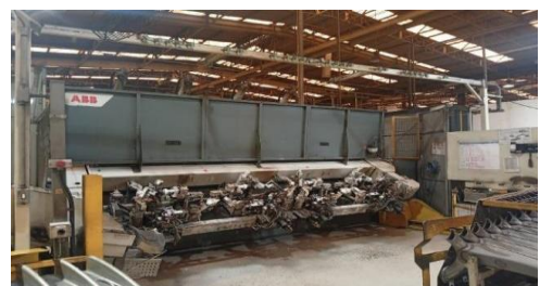
Figura 15- Máquina com os sensores instalados no suporte.
