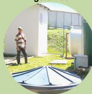
Estação de Tratamento de água
