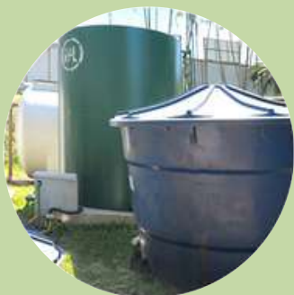
Estação de tratamento de água
