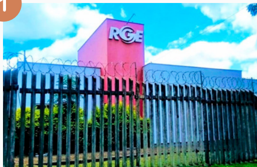
Figura 93: Subestação de energia elétrica RGE. Fonte: Santo Cristo, 2018.
