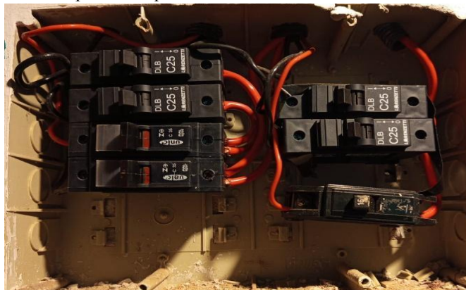
Fig. 8. Quadro de distribuição de energia em condições precárias. Autor: Autoria própria
